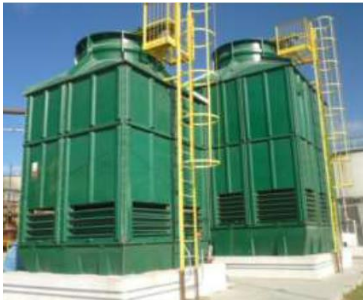
Figura 10 - Torre de resfriamento.
