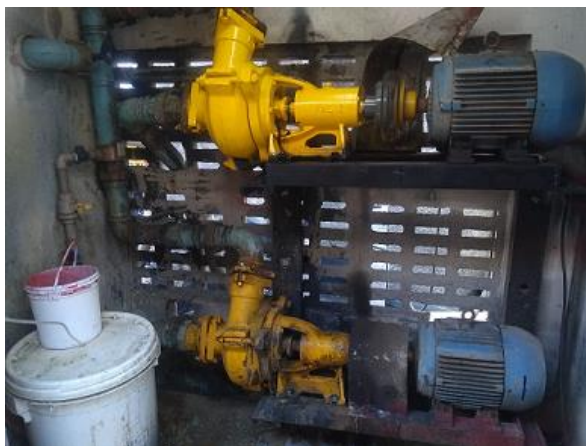
Figura 13. Bombas Estação Elevatória.
