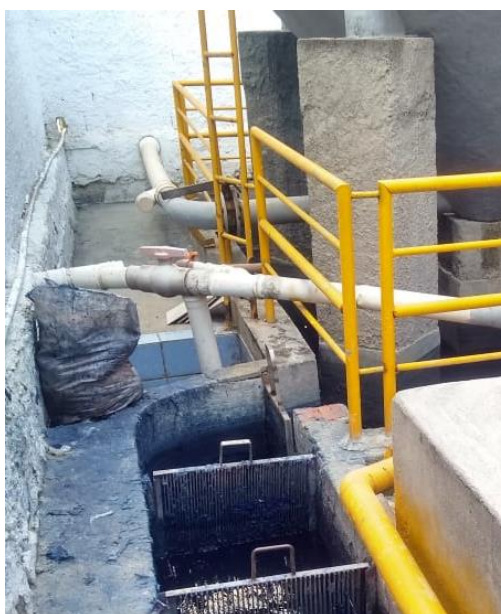
Figura 10. Sistema de gradeamento da “ETE X”.
