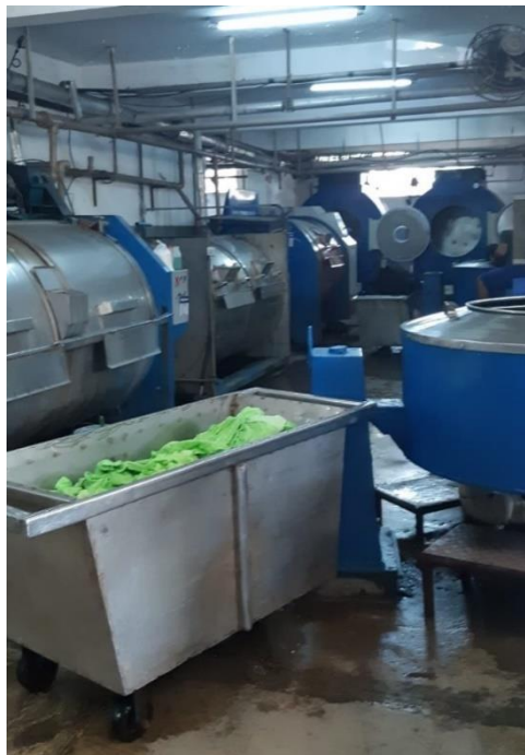
Figura 11: Máquinas industriais de lavar da “lavanderia Y”
