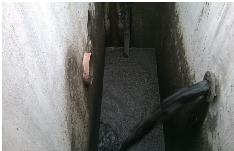
Figura 9. Elevatória de lodo.
