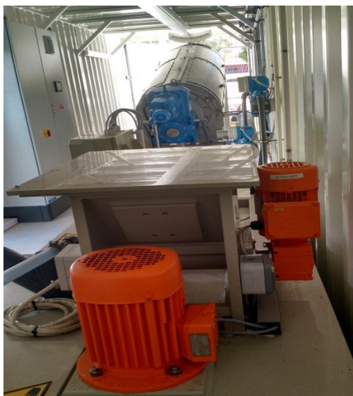
Figura 16. Visão Geral do SKID.
