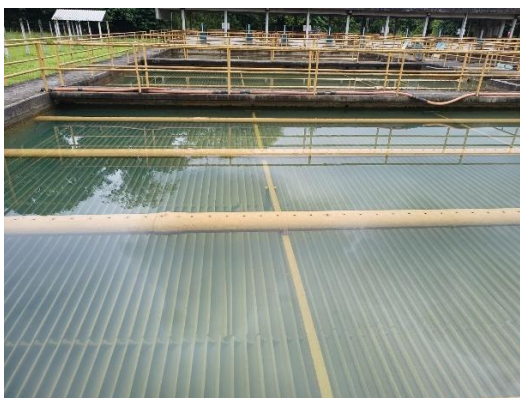
Figura 2. Decantadores da Estação de Tratamento de Água do sistema Gurjaú.
