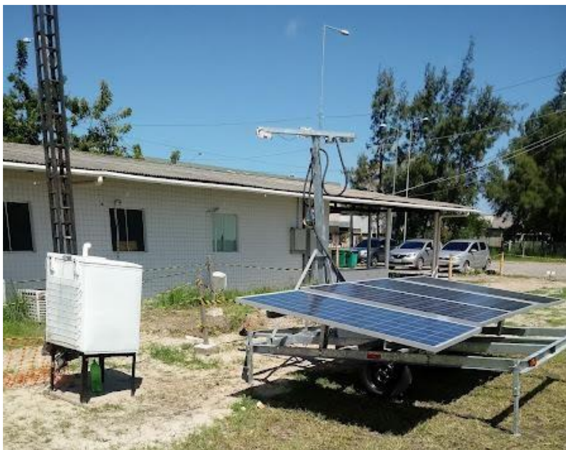
Figura 23: Paineis solares de alimentação do protótipo.
